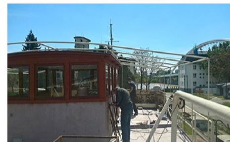
2017 Člen Klubu ochrany technických pamiatok počas renovácie kormidlovne, sponzorsky zabezpečená Ing. Jakubom Ďurindom
