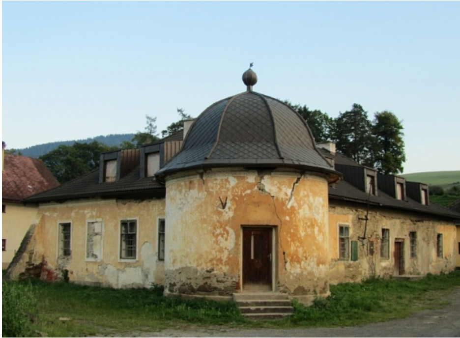
obr. 53 Brezovica – renesančný kaštieľ, polovica 17. storočia. Súpisné číslo objektu 299 NKP. Kaštieľ je vo veľmi zlom stave. Slnéčné hodiny opísané p. P. Adamuvom v roku 1980 zrejme už nie je možné identifikovať. autor foto: Ladislav Barabás
