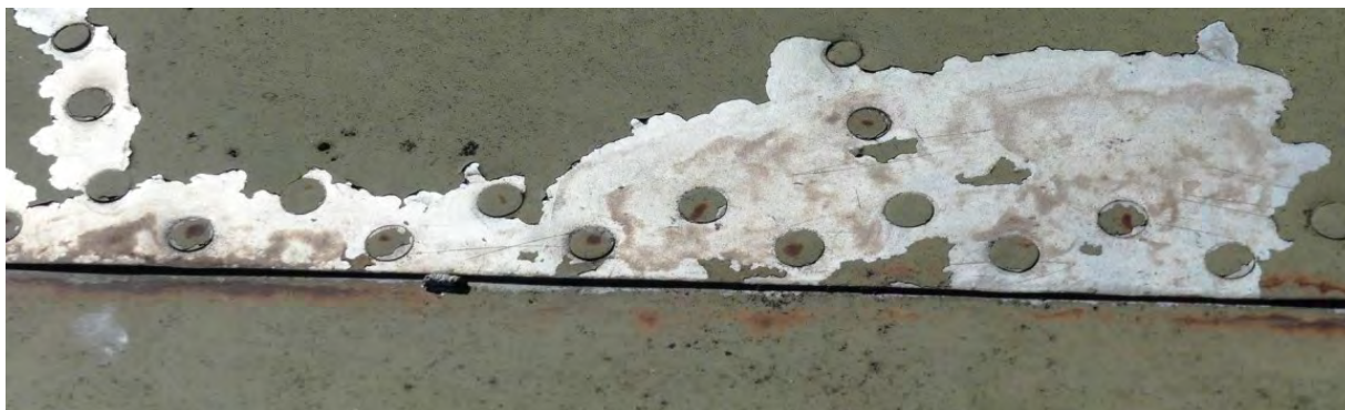
Obr. 125 - Koróziou napadnutý povrch výškového kormidla
