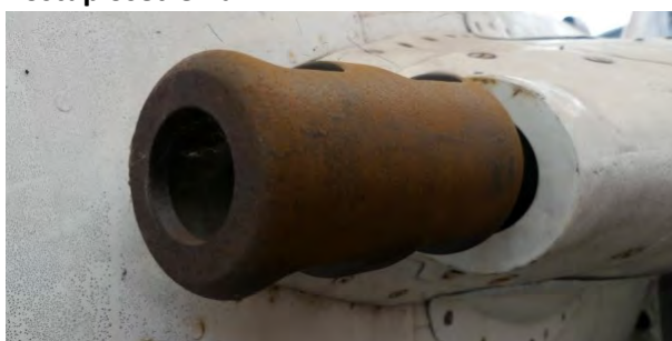
Obr. 131 - Odstránenie korózie z hlavne ejektora
