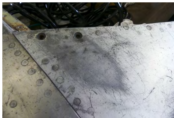
Obr. 230 - Mechanické odstránenie korózie č. 1
