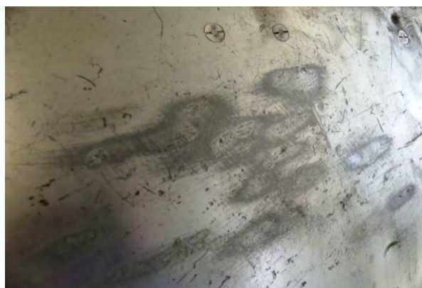
Obr. 231 - Mechanické odstránenie korózie č. 2
