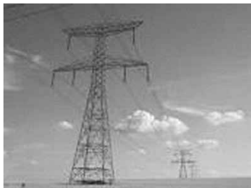
Vedenia určené na prenos a distribúciu EE
